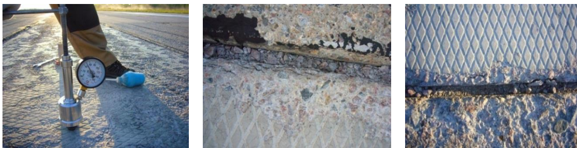
Рис. 7. Обследование аэродромных плит в аэропорту «Хибины». Разрушение поверхности плит и ребер плит на стыках
